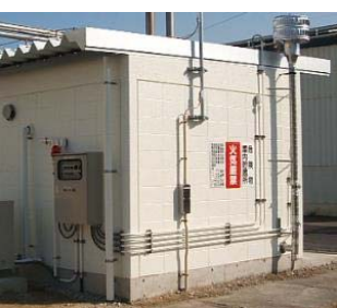
防爆冷蔵保管庫
